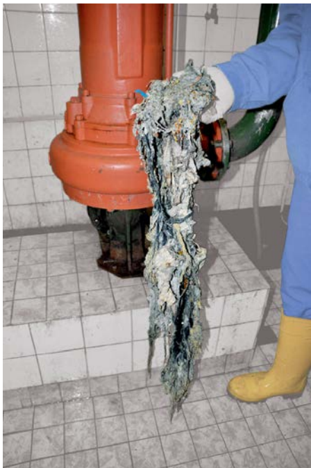
Strang aus verfilzten Feuchttüchern, wie er regelmäßig Pumpen lahm legt (Bildquelle: OOW, Oldenburgisch-Ostfriesischer Wasserverband, Brake, www.oowv.de )
